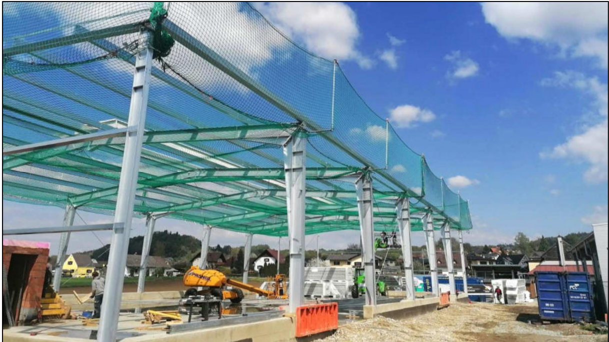
Abbildung 27 - Absturz- inkl. Randabsturzsicherung
