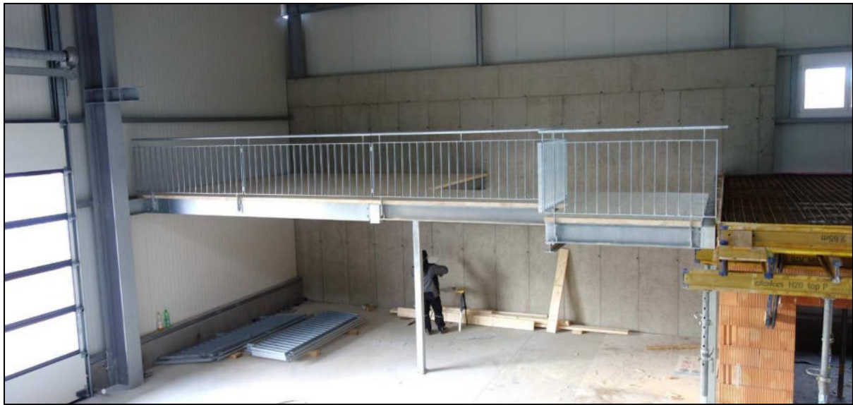
Abbildung 49 - Technikpodeste, Gitterpodeste, Zwischendecken
