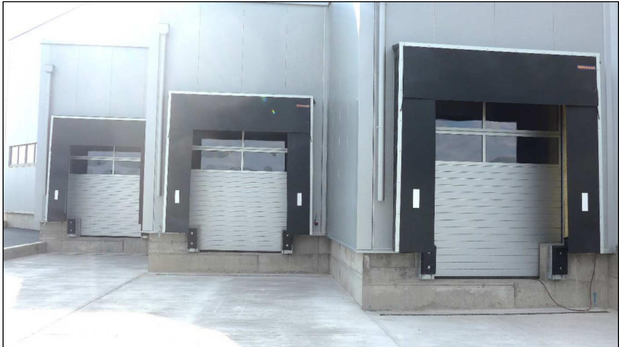
Abbildung 52 - Verlade- Andockkrampen, Schleusensysteme
