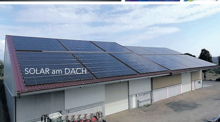
Biolandbau Holl KG, 3910 Zwettl (NÖ) Technische Details: 3 Wechselrichter mit einer Gesamtleistung von 198kVA, 720 Module mit einer Modulspitzenleistung von 306kWp.
